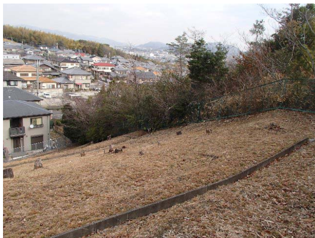
○敷地北側に隣接する市管理の法面はヤブが伐採されている（手前）が、私有地は手入れがされていない（奥）。
