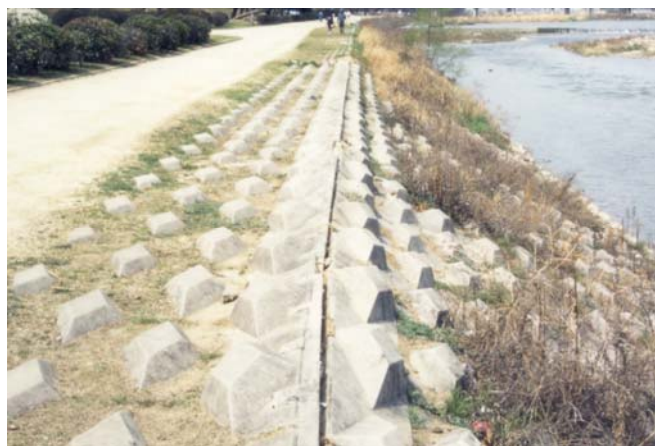
写真-4 接続ブロック：隙間がないので植性は貧弱
