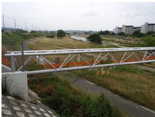
○新北橋は昨年の出水で損傷し、工事のためにその下の園路が通行止めになっている。
