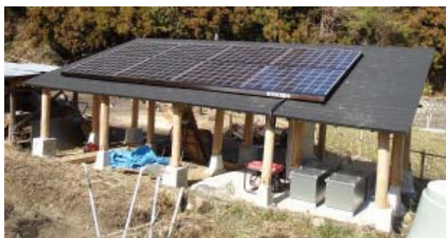
2013年1月に完成したソーラー発電システム
